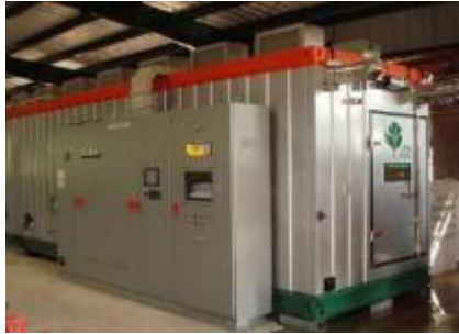
Hình 42: Hệ thống xử lý nước nóng
